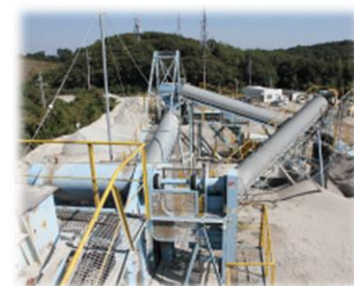
振動篩～ベルトコンベヤ
